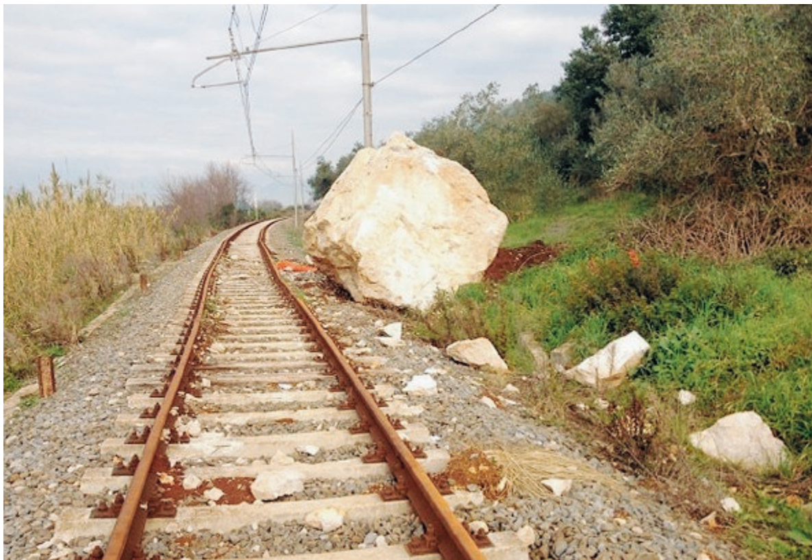
La foto di un masso caduto sul binario, chiuso dal 2012
